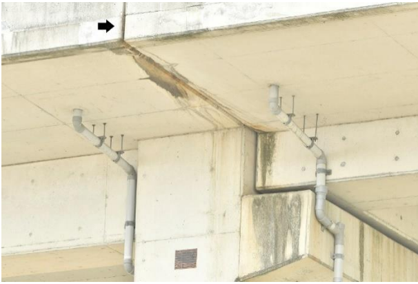
図2 新幹線高架のコンクリートの隙間（矢印）。
